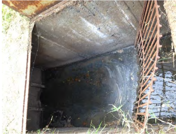
Figure 9 : Dégrillage en entrée de station
